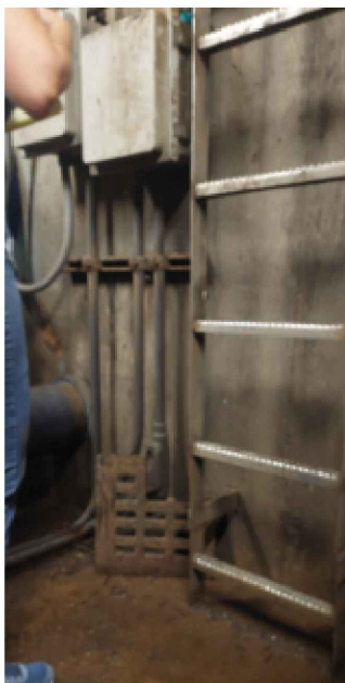
Ladder, Conduits, Grate
