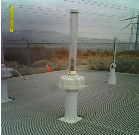
Old Manual Actuators
